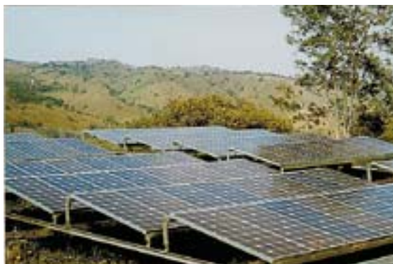
Figura 8. Sistema fotovoltaico de Capurí, Panamá.
